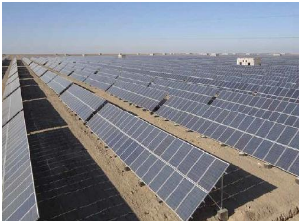
甘肃永昌100MW光伏电站 甘肃省内最大的并网光伏电站
