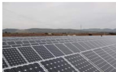
中国甘肃敦煌50MW电站
