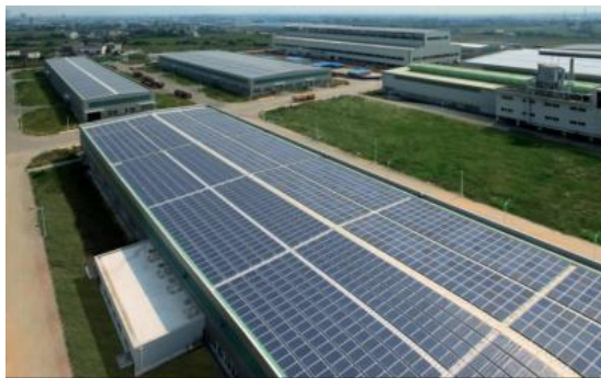
湖州长兴中钢集团厂区屋顶光伏电站
